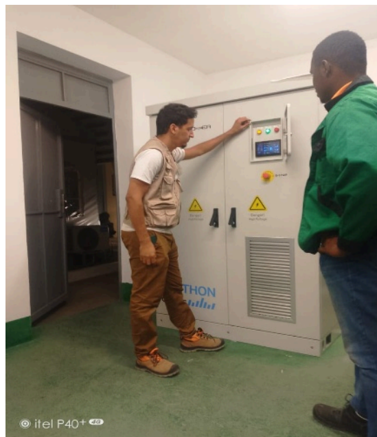
Les équipements électriques
