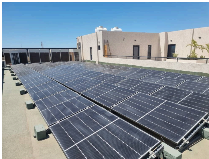
Le solaire en toiture
