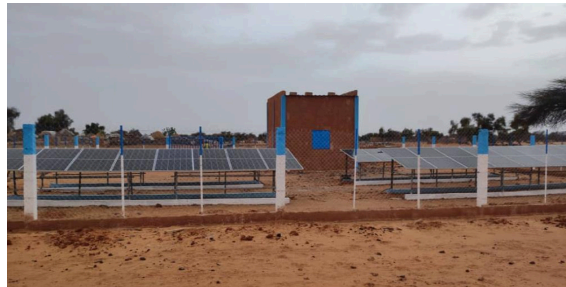
Infrastructures hydrauliques · Photographie CDS
