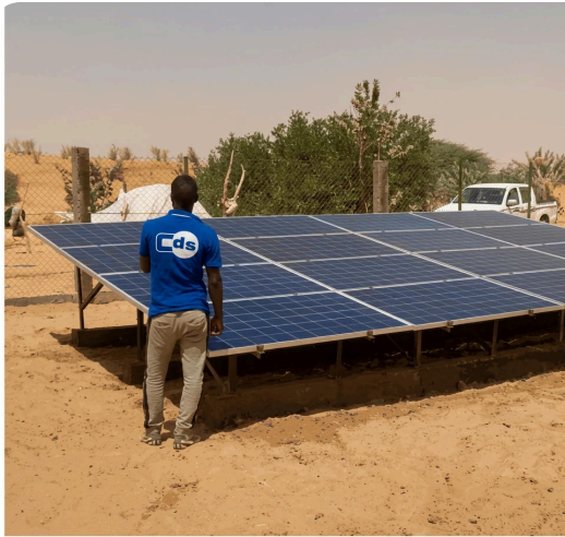
Pompage hybride à Tiguent
