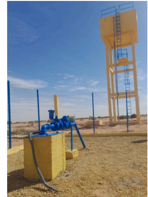
Les ouvrages de pompage
