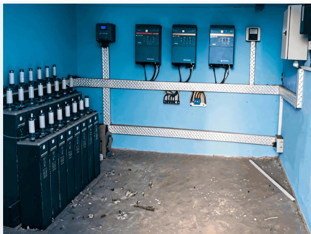
Salle de contrôle électrique
